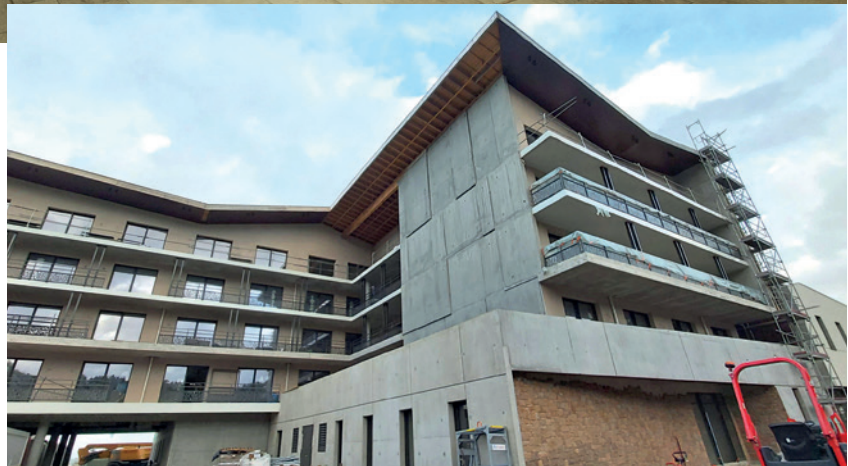
La Thalasso Roz Marine à Perros Guirec, en construction © Photo Julien Majou
